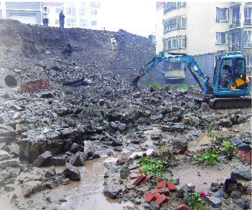
倒塌的墙,里面有相当部分建筑瓦砾。 刘志浩 摄
