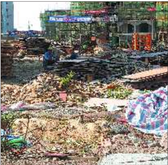
工地上摆放着凌乱的建筑木板,没有任何防护设施。 本报记者 张牟幸子 摄
