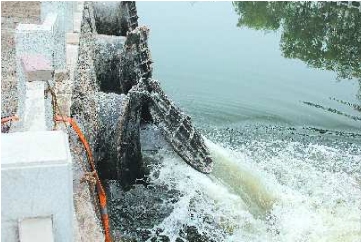
渤海七路上的5号泵站排水口。图片由市政处提供
