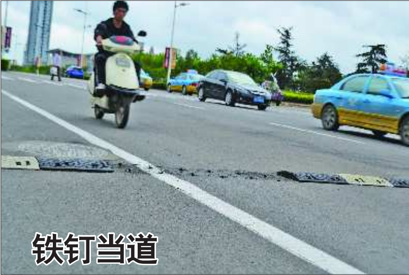
6月26日,泰安路与烟台路交叉口东侧,一处马路减速带上的橡胶少了一块,里面的铁钉露了出来。
