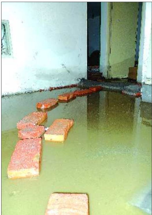
雨后两天,地下室里的水依然很深。 本报记者 马云云 摄
