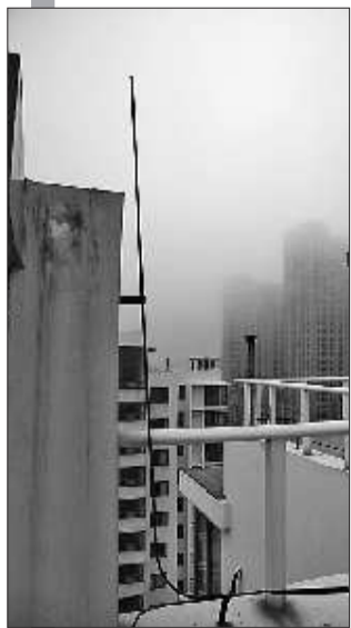
▲居民楼顶安装了避雷针和钢筋组成的避雷线路,它们是建筑物的“守护神”。
