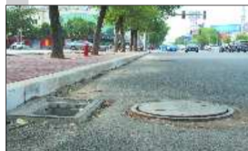
渤海七路一处井盖高出地面5厘米。
