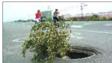
黄河十二路路口一处井盖丢失,只留下插着树枝的“黑洞”。
