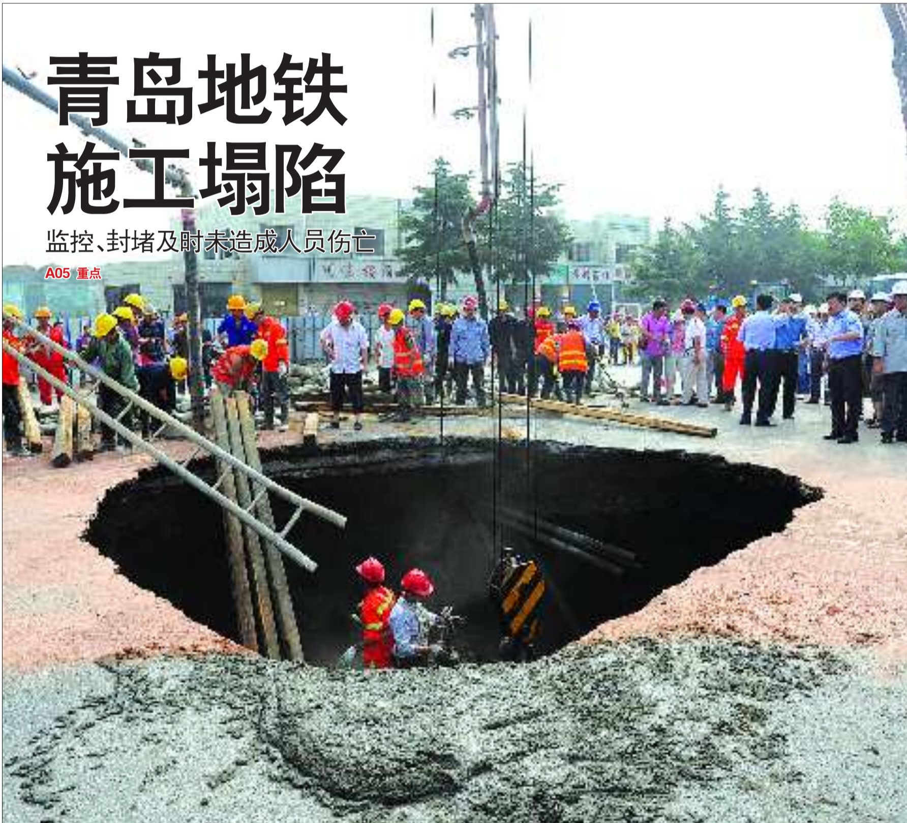
▲17日早晨,青岛京口路和重庆中路交会处的地铁施工区域出现局部路面塌陷,面积达五六平方米。上午11时左右,经过5个多小时的抢险施工,坍塌口回填完毕。事故未造成人员伤亡,事故原因正在调查中。 CFP供图
