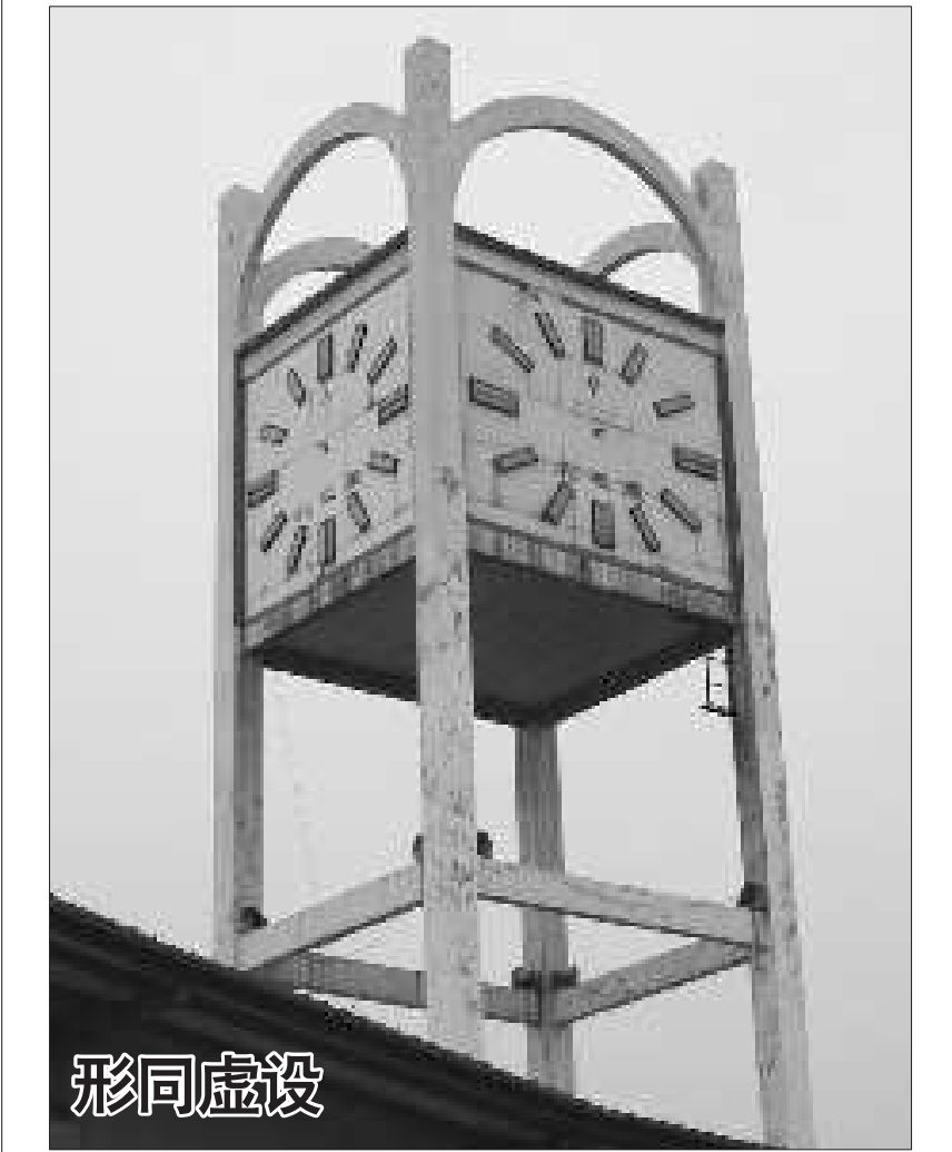
18日,记者从枣庄市台儿庄区汽车站发现,该汽车站楼顶钟表已经没有了指针,无法给旅客进行时间提醒,此钟表已经形同虚设。
