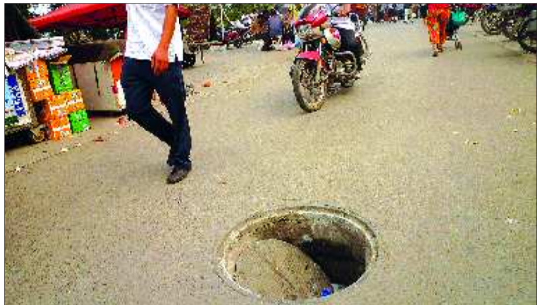
这个下水道井口张着嘴,已经连续把人伤。 本报记者 杜洪雷 摄
