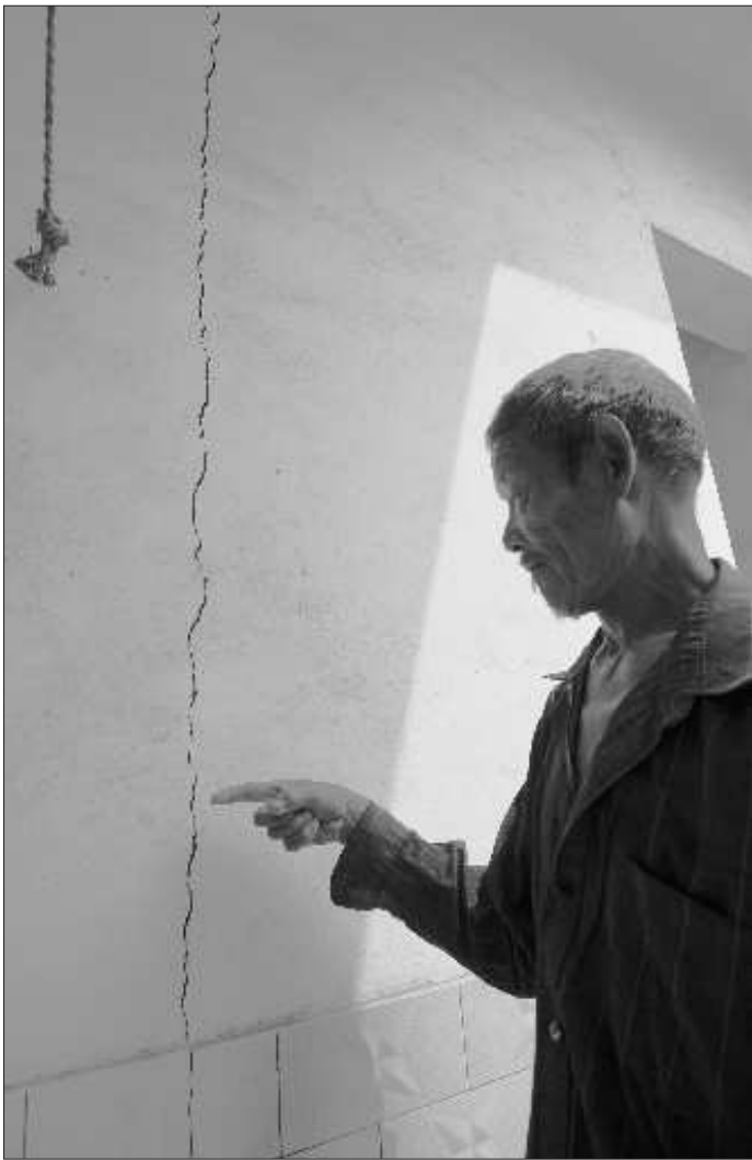
▲李景华的房子建成不到1年,已经出现了多条裂缝。
