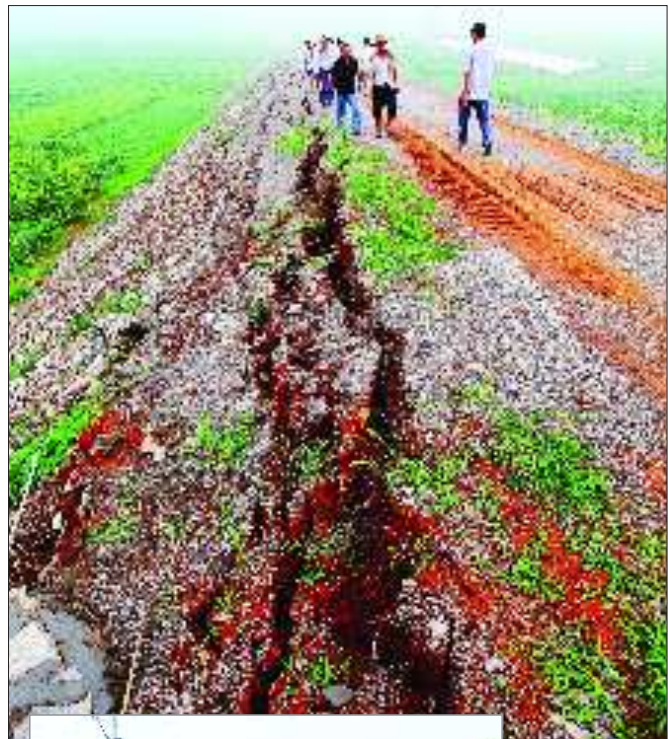
▲高架桥出现了裂缝,村民们担心行路安全。
