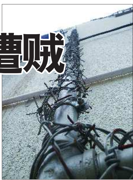
为了防盗，莘阳小区居民多在管道上绑着铁蒺藜。 本报记者 刘守龙 摄
