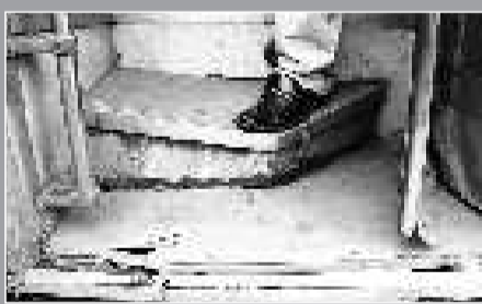
一名乘客从35路公交车下车时,一脚踩在因腐烂而倾斜的下车处。
