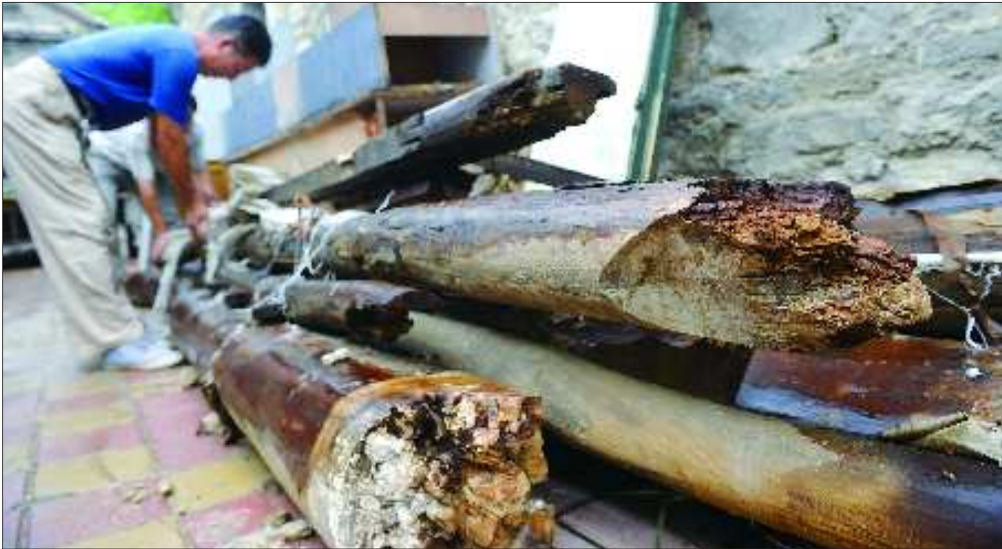
▲拆下来的房梁已经腐朽。
