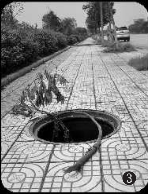
③在东湖附近西昌北路的一人行道上，一下水道井盖丢失，据记者不完全统计，该下水道井盖至少丢失了半个月，有好心人在上面放了树枝提醒路人，希望有关部门能管一管这事。
