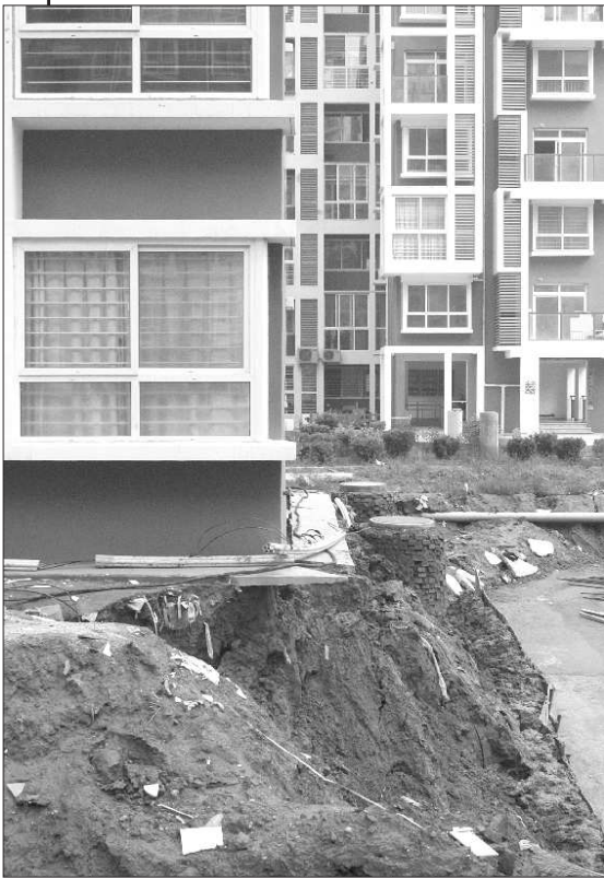
小区2号楼离正在建设的地下停车场很近,由于近期限雨底部泥土都被冲刷掉。
