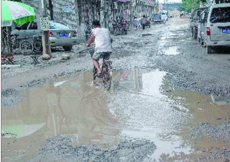
一场雨后,破损的小路就变成了“泥湾”。 本报记者 赵丽 摄
