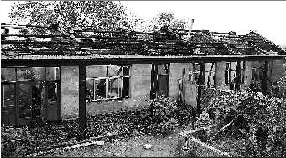
张银环家中的7间新瓦房房顶都被烧塌了。 本报记者 马志勇 摄
