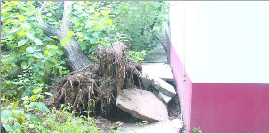
水泥板。本报首席记者 聂金刚 摄 大树被吹倒掀了楼房部分地基,毁坏了上面的
