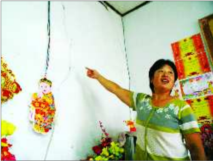
▲梁培磊家墙上的裂缝。
