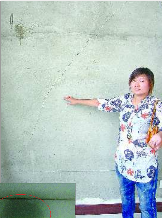
▲张德民家东墙出现的裂痕。 ▲刘先生的饭店西墙仍有清晰可见水痕。 本报记者 周千清 摄
