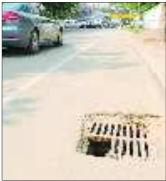
▲“惹祸”的雨篦子缺口处很尖锐。 记者 吕修全 摄
