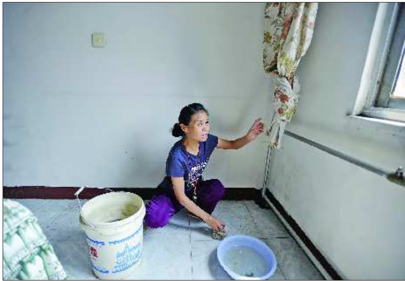
李女士正在清理从屋顶漏下来的水。 本报记者 王媛 摄
