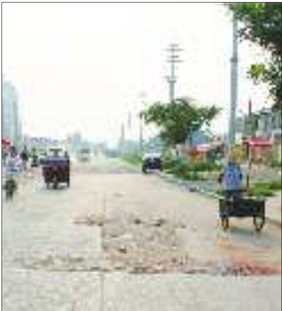
解放路大明佳苑段路面坑洼不平。 记者 张冬梅 摄
