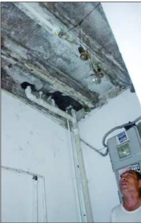
▲一居民家的卫生间里,屋顶上的水泥掉下来很多。
