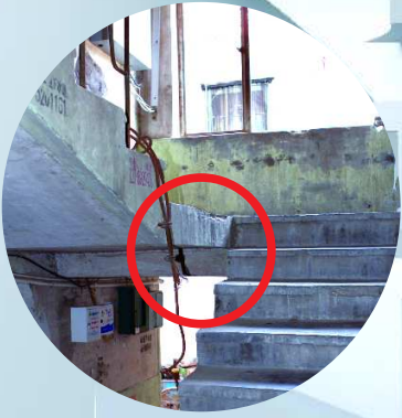
自一楼楼梯拐角处向下,近2米高的楼梯都没有扶手。 本报记者 吕修全 实习生 刘云龙 摄
