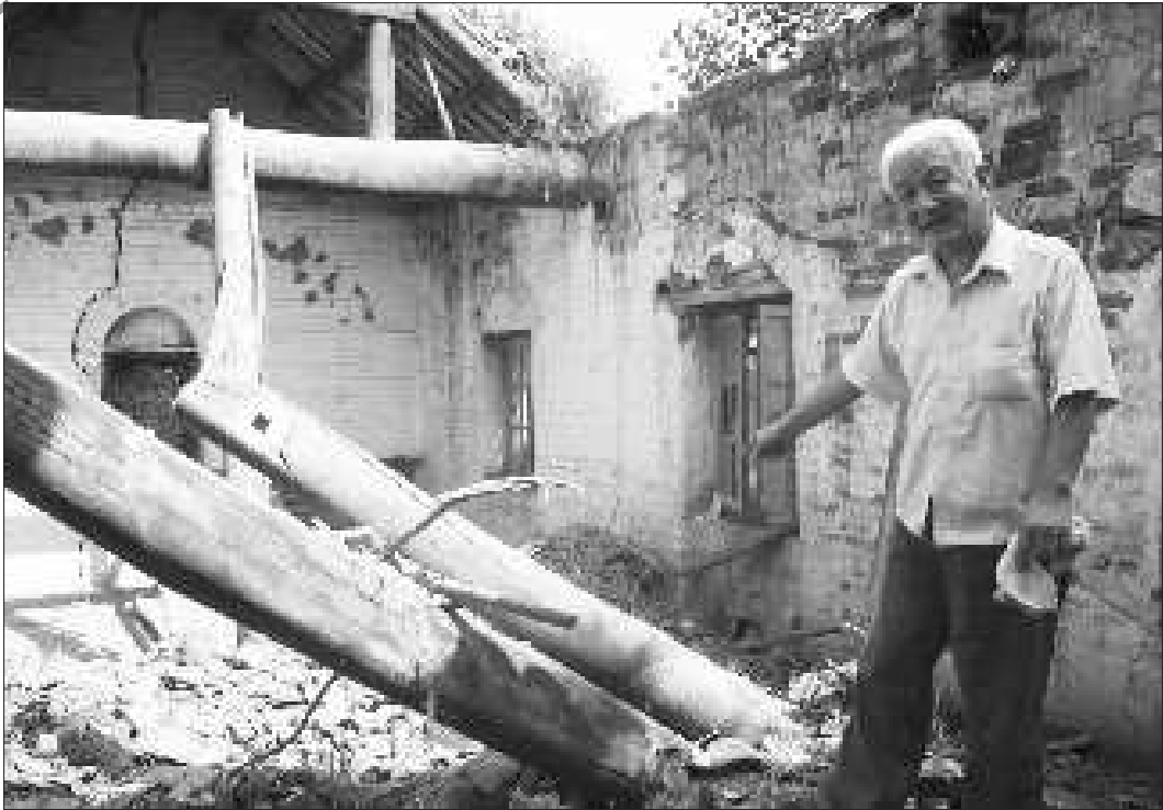
孙思海站在二楼上,无奈地看着坍塌的房顶,希望尽快得到修缮。
