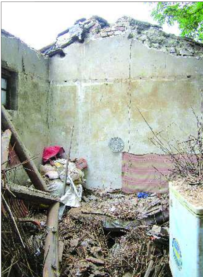
屋顶坍塌的老房子。
