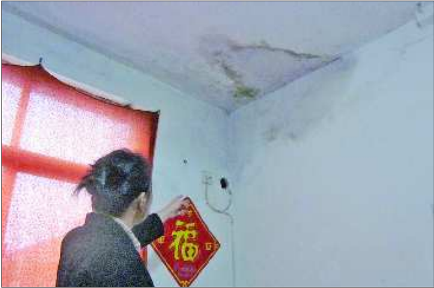
平改坡后部分顶楼住户家中出现漏水。本报记者 尹明亮 摄
