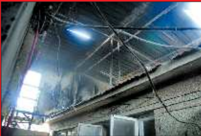
搭建在房顶的15间板房被烧光。
