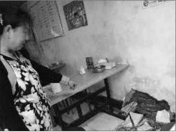
罗先生饭馆的墙面马上就要被震穿。
