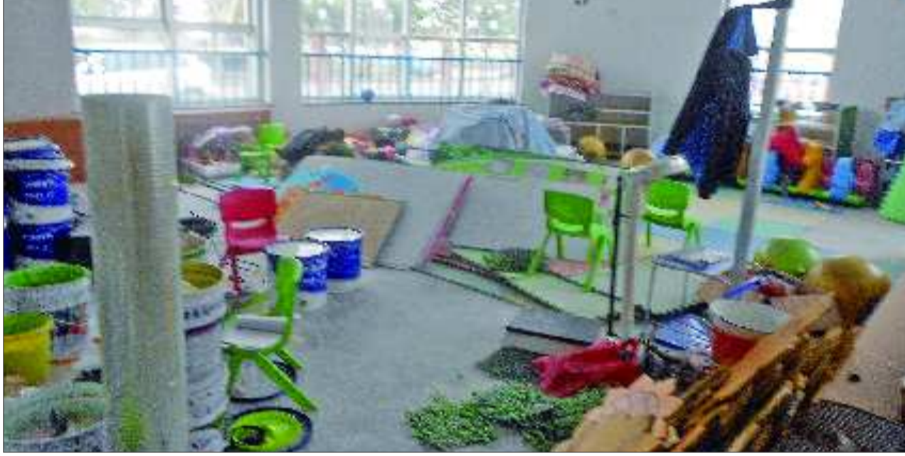
教室里堆满施工用品。 见习记者 张文 摄
