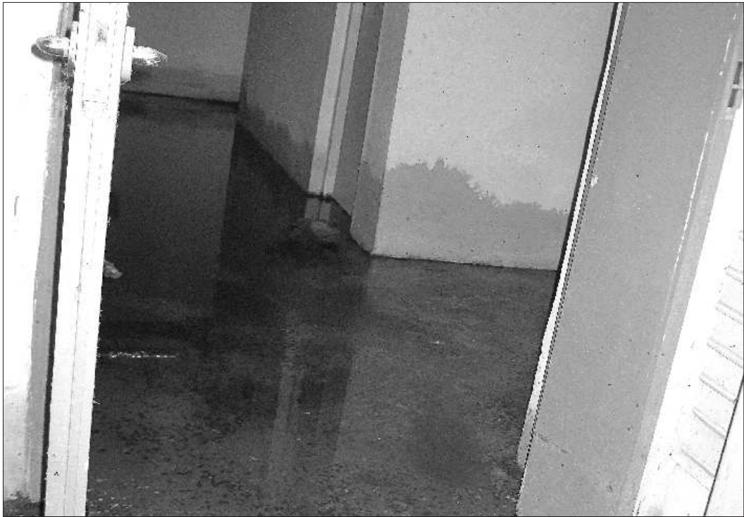
储藏室地上依然有积水。 记者 张冬梅 摄
