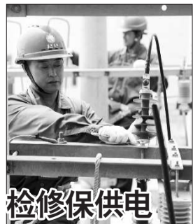
近日,东营区供电公司组织电力工作人员对全区供电设备进行安全“体检”,提高其运行能力,保证全区电网安全稳定运行。 本报通讯员 隋湘敬 本报见习记者 杨琼 摄影报道
