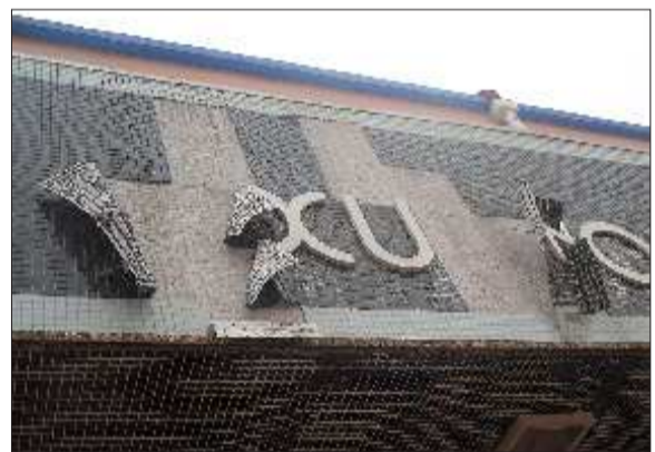
▲高女士商铺破损的广告牌。侯晓 摄
