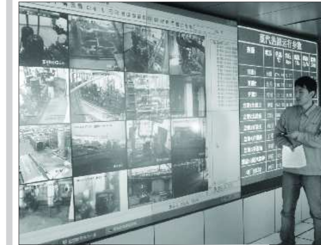
图为数字化换热站的视频监控系统。
