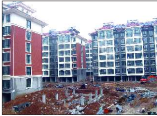
配电室还没建好。 侯冬冬 摄
