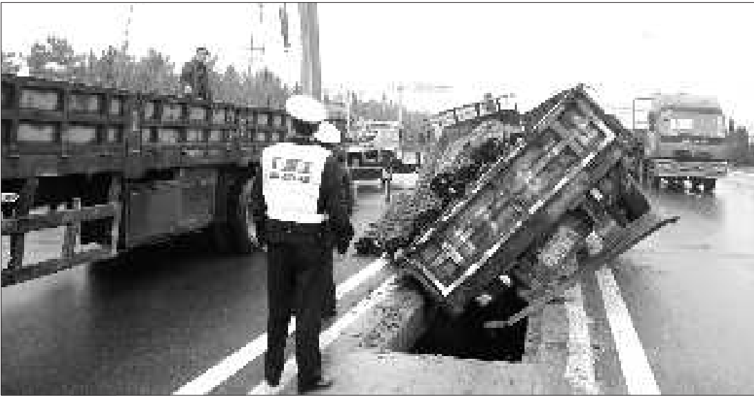
因车辆超载严重,桥面隔离带的水泥板被压塌,货车后轮卡进裂缝不能动弹.本报记者 陶相银 摄
