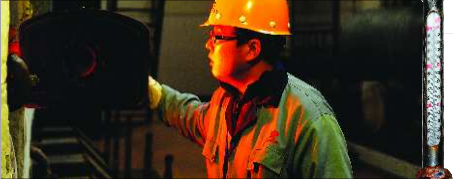
◀8日,济南西八附近的换热站,入口蒸汽温度达到130摄氏度。 本报记者 周青先 摄
