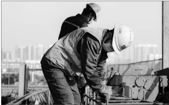
在济宁市文化中心三期项目施工现场,工人戴着口罩施工。
