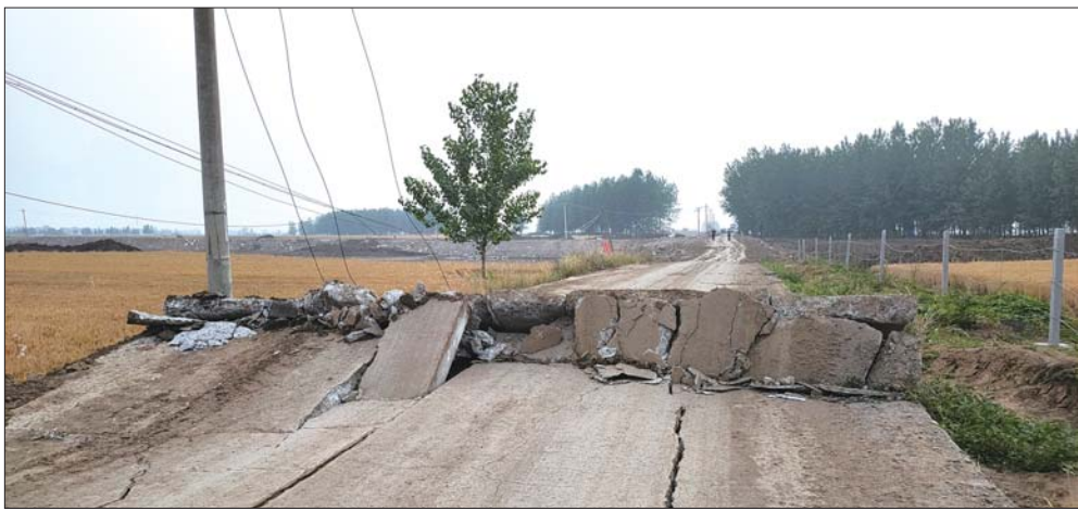
此次塌陷造成村庄部分道路受损、架线杆倾倒。受访者供图
