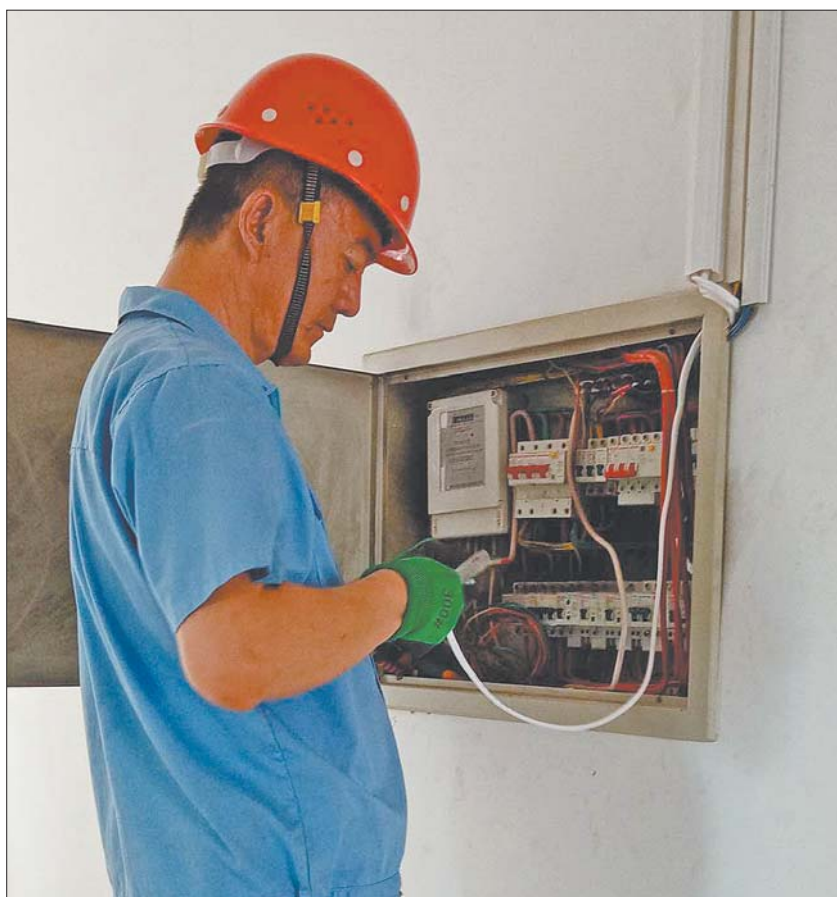
▲工作人员 日常检修。
