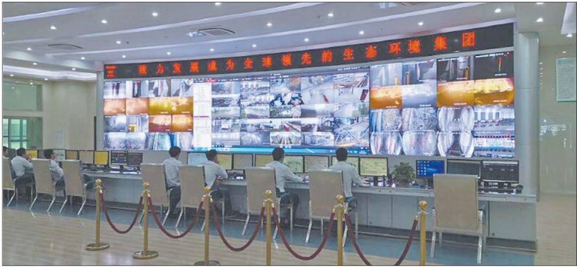
工作人员在监控垃圾燃烧发电。
