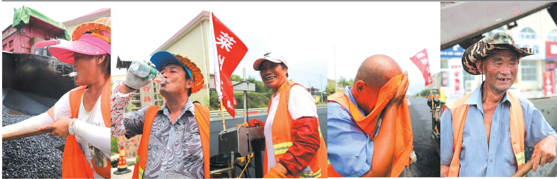
省道307莱州段大中修工程一线施工人员鏖战三伏,确保工程按时按质完工。
