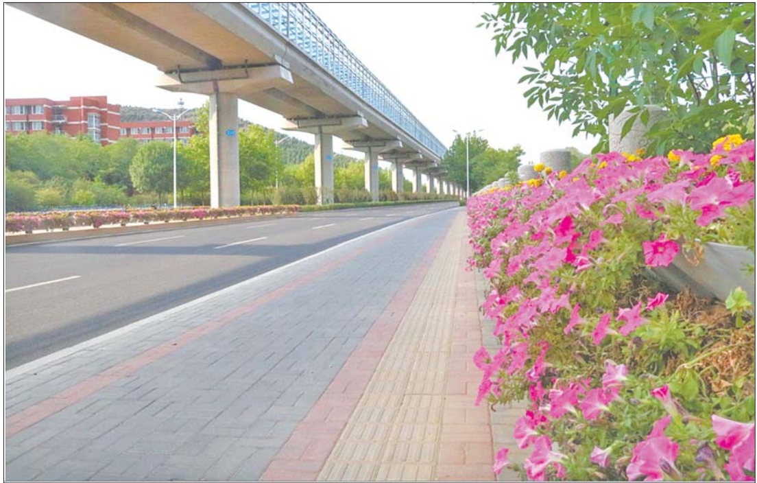
长清区住建局主动承接轨交1号线线下道路恢复工程,克服困难确保正常通车。
