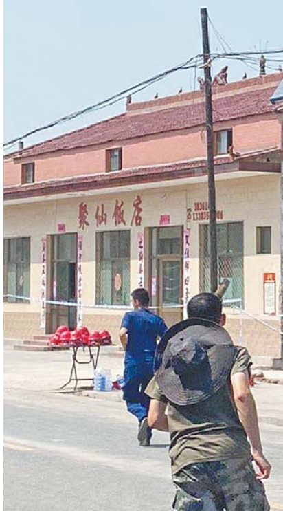
事发的聚仙饭店门口，坍塌的是第二排房子。
