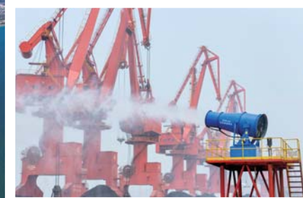
山东港口日照港环保配套设施防尘喷淋现场
