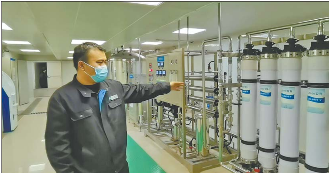
位于鲁能领秀公馆地下车库的泉水直饮水处理设备。
