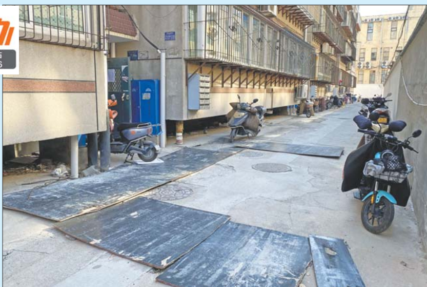
1单元楼门前电梯井道位置盖着几块木板。
